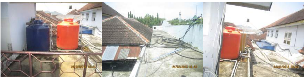
Gambar 2.5 kondisi utilitas di RSUD dr. Soedomo Kabupaten Trenggalek
